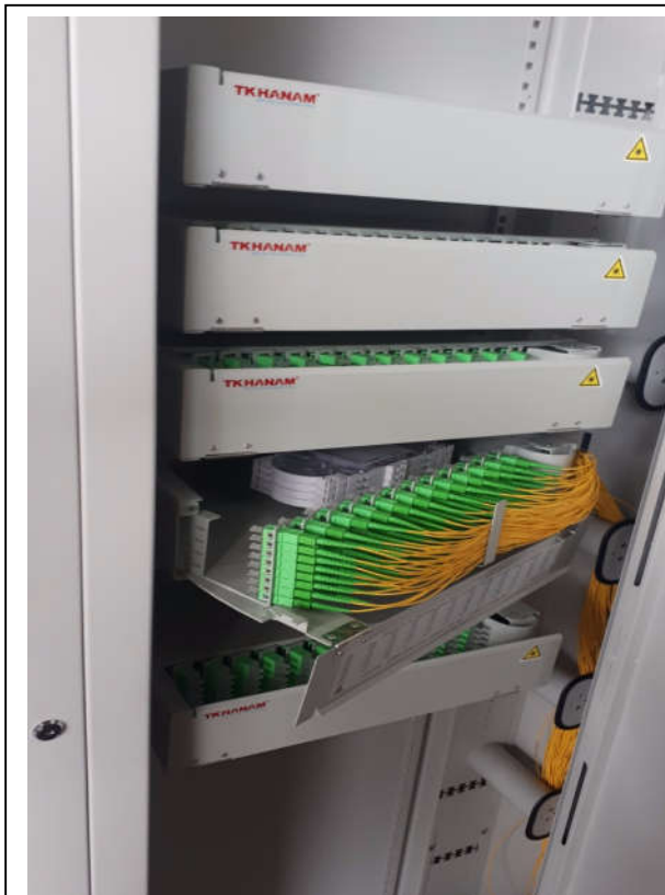
Tủ tập trung TKFib – MODF-1632
